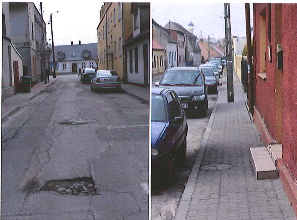
FOT. 4 PRZYKŁADY PROBLEMÓW TECHNICZNYCH W ZAKRESIE INFRASTRUKTURY DROGOWEJ NA OBSZARZE REWITALIZACJI
